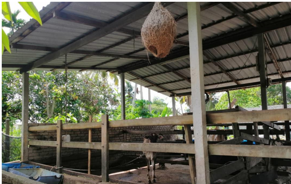
Railing kayu ditukar dengan GI Paip dan tiang railing serta tembok perlu diplaster simen.
